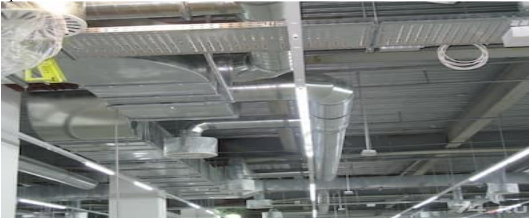
Рис.1. Ефективна система кондиціювання приміщень виробництва
